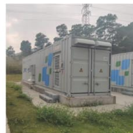
Contenedor de Baterías
